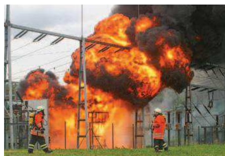
Umspannwerk in Flammen.
